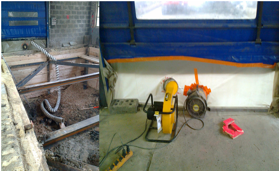
Figure 15 : Système de ventilation de la zone de travaux
